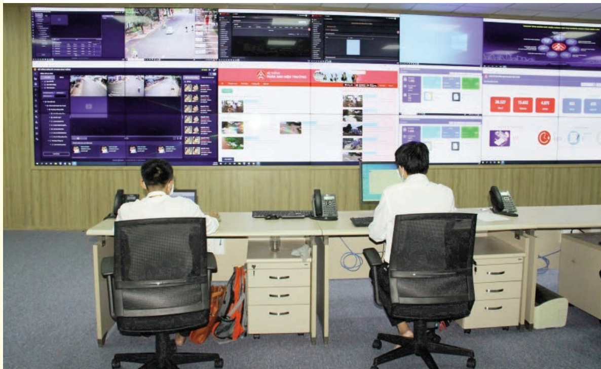
Trung tâm điều hành thông minh tỉnh Đắk Lắk
